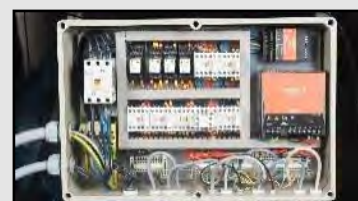
Rif. 4: Quadro elettrico
