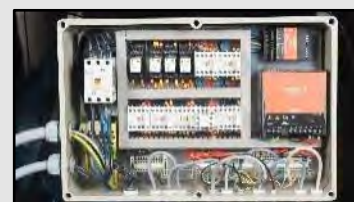
IMG. 4 : Panneau électrique hermétique
