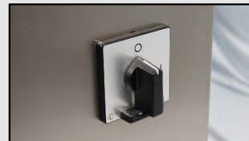
IMG. 6 : Interrupteur principal
