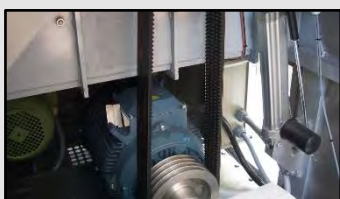
IMG. 10 : Courroies de transmission
