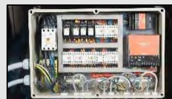
IMG. 4: Cuadro eléctrico
